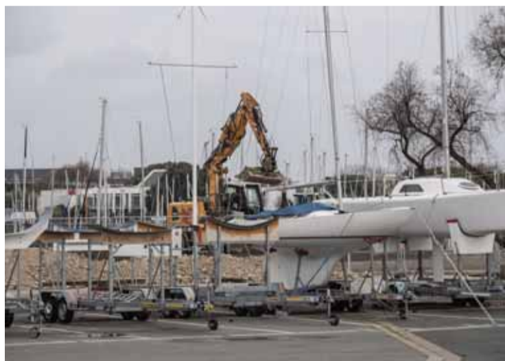
Le siège de la SRR, situé avenue de la Capitainerie, a été rasé. Il fera place au centre de recherche de Tribord. PHOTO XAVIER LÉOTY
